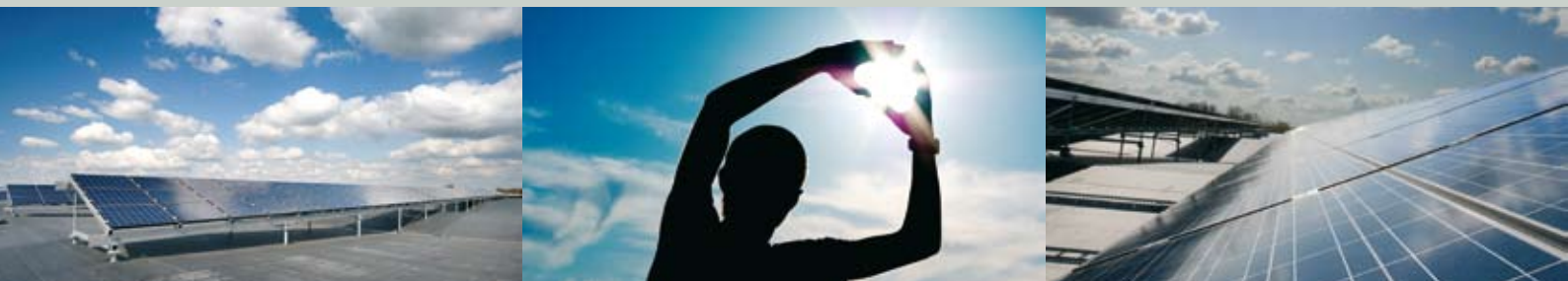
Reynaers - panele słoneczne na dachu nowego centrum dystrybucyjnego - Belgia
